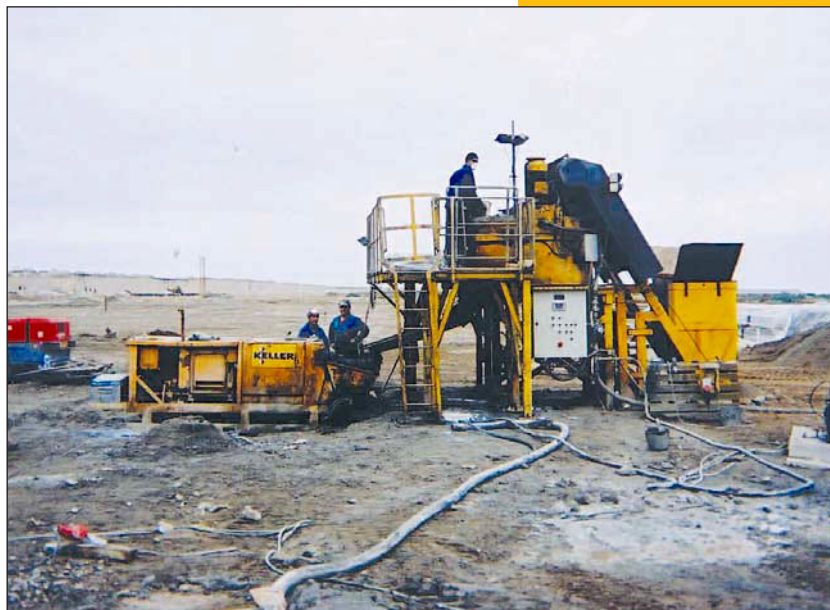
▲ Vue d'ensemble de la centrale à mortier
